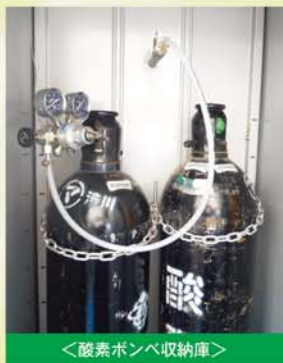
<酸素ポンベ収納庫>
